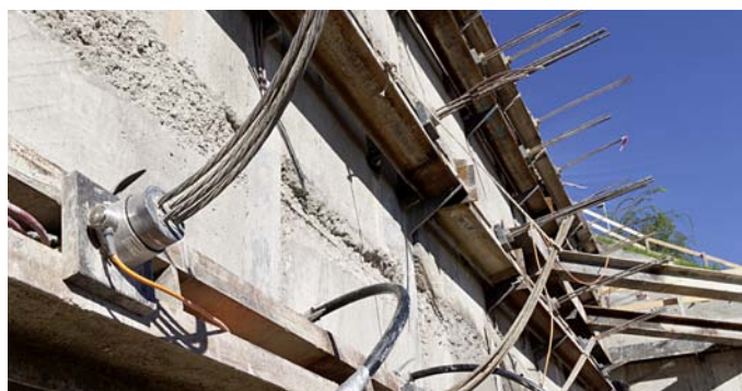
Kraftmessdose PRE 1000/100/80 zur Überwachung einer Stützmauer
